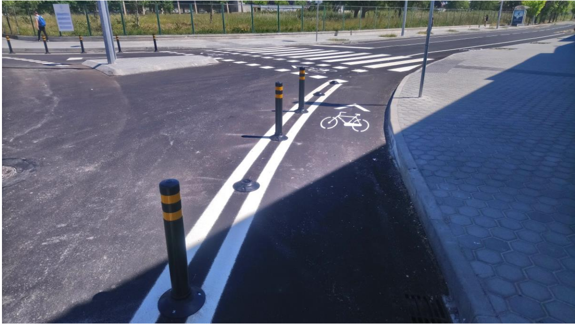
Fig. 2: Pilaretes arrancados, menos de uma semana após abertura da rotunda.
